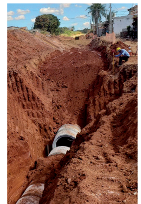
Perigo de desabamento e soterramento de trabalhadores
